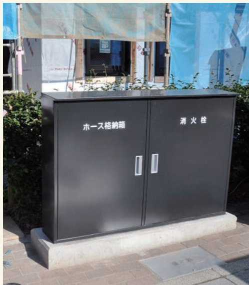
消火栓 横丁内での火災に備えて新設した消火設備。
