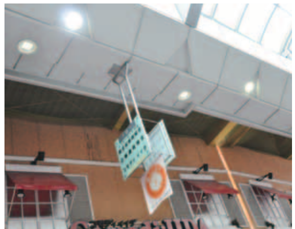
照明をLEDに切り替えた商店街のアーケード
